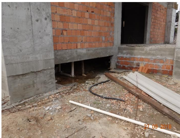
FIGURA 12 – DESNÍVEL CRIADO EM FUNÇÃO DA ALTERAÇÃO DA COTA DE PROJETO DO AUDITÓRIO
