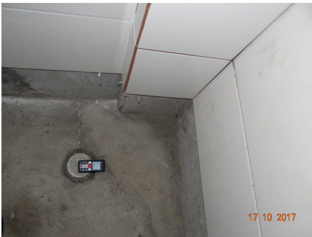
Foto 2 – Medição da distância entre o eixo do vaso sanitário e a parede do banheiro PNE próximo à recepção.
