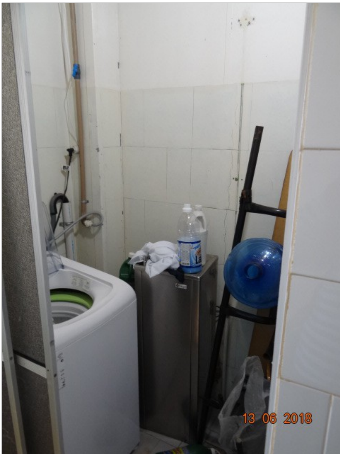
Foto 008 – Sanitário servindo como depósito e lavanderia, gambiarras elétricas e hídricas.
