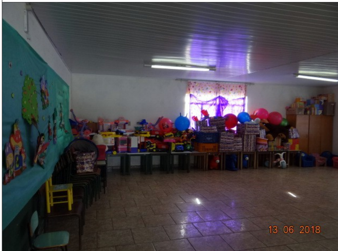
Foto 004 – Sala de atividades múltiplas (ventilação e iluminação natural deficitária).
