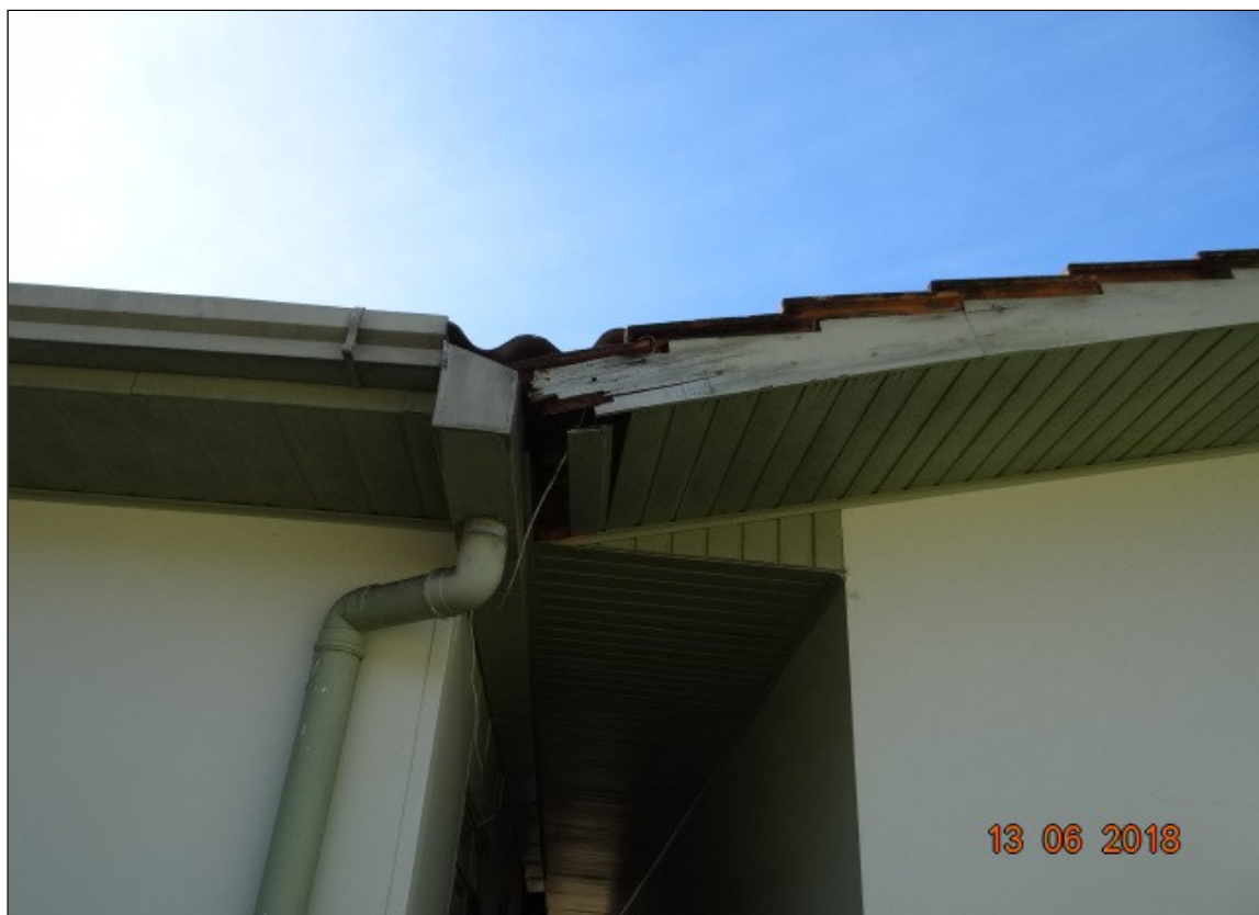
Foto 003 – Beiral danificado, necessitando de reparos
