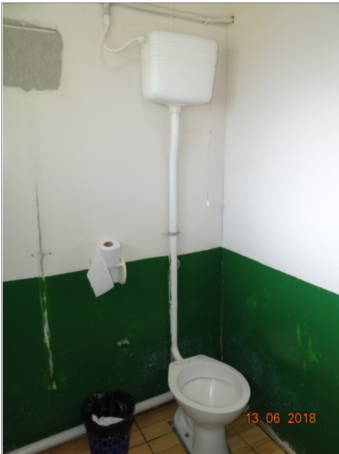
Foto 005 – Instalações sanitárias inadequadas
