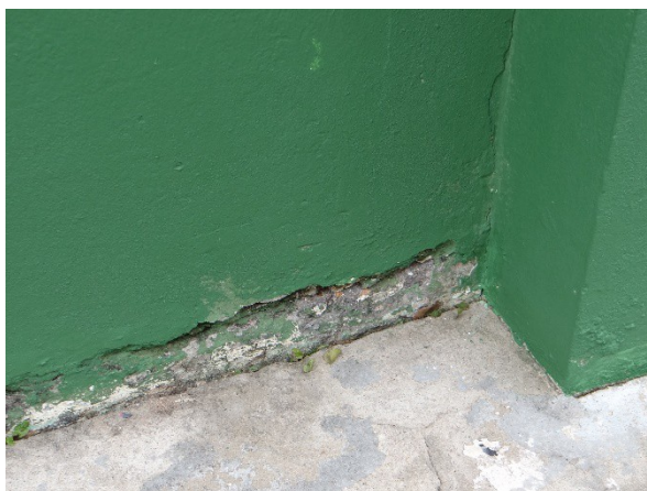
Foto 2 – Péssimo acabamento da pintura rente ao chão.
