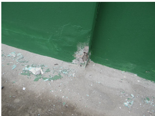
Foto 3 – Pintura feita sobre o reboco descolando, sem o reparo anterior do mesmo.
