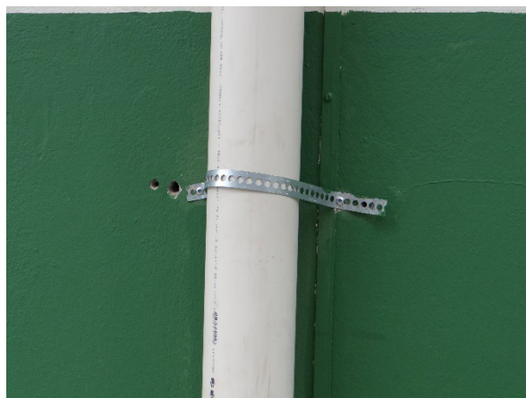
Foto 4 – Abraçadeira inapropriada para descidas pluviais, podendo causar ferimentos aos alunos e funcionários pelas pontas vivas e cortantes.
