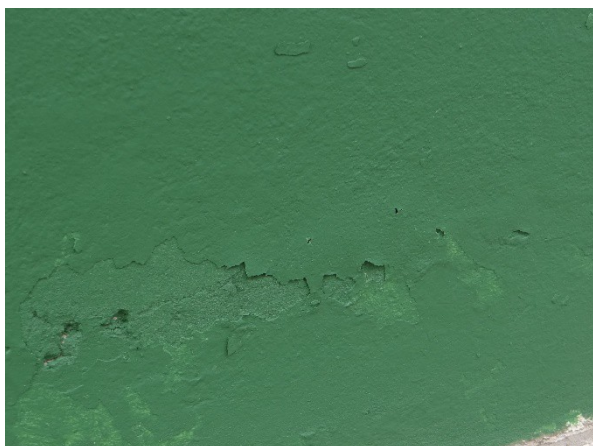
Foto 1 – Pintura sendo executada diretamente sobre a pintura antiga, sem raspar a pintura existente que estava soltando da parede.
